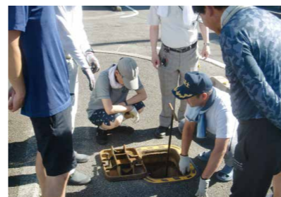
消火栓の確認
