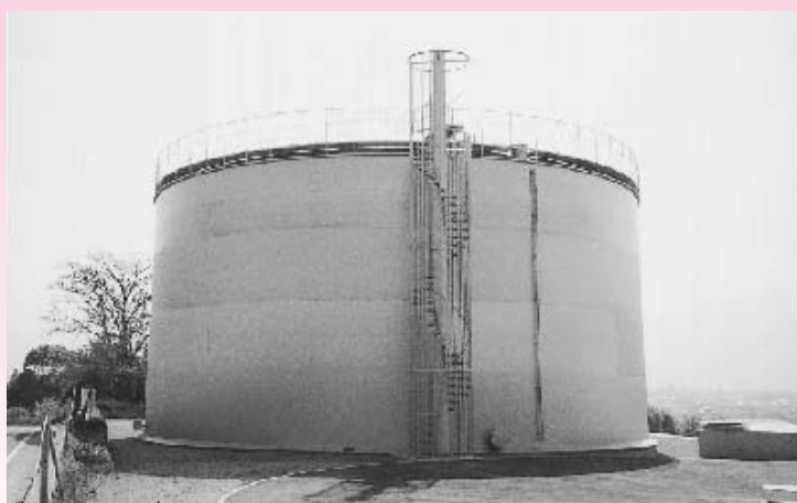
～ 重信地区統合簡易水道事業(配水池) ～ 総事業費 977,718千円 (うち財政融資資金 639,800千円)
