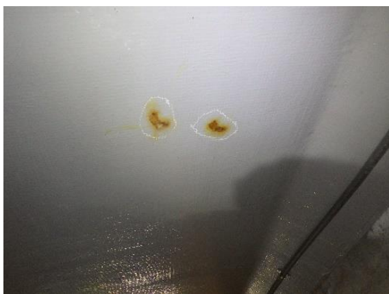
天井 炭素繊維シートの劣化
