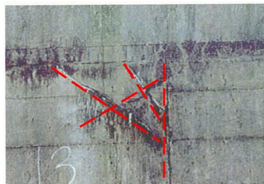
写真-解 8.1 ブロック化したひび割れの例
