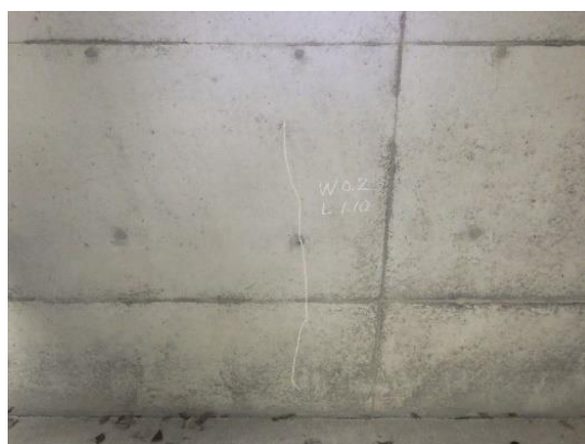
側壁 ひびわれ
