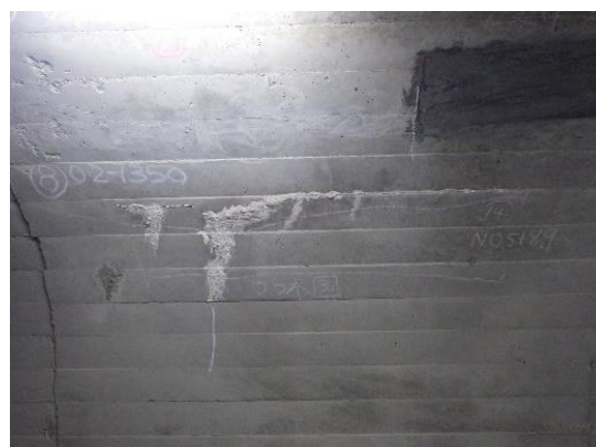
アーチ部 漏水跡
