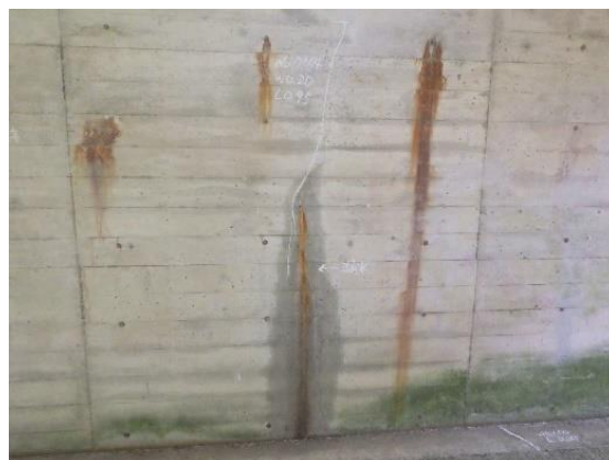
側壁 漏水状況
