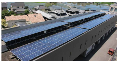
市役所庁舎屋上に設置されている太陽光発電パネル
