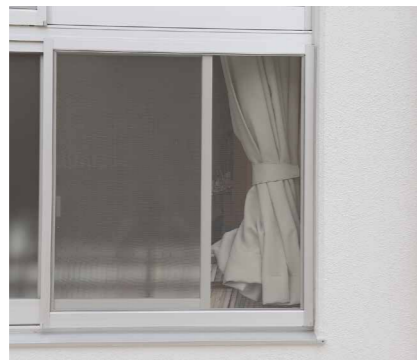
北吉井小学校西校舎の設置網戸
