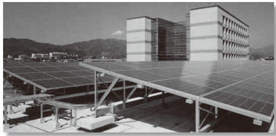
重信・川内中学校の改築にあわせた太陽光発電の導入を
