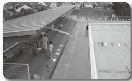
太陽光発電パネルが設置される川内中学校プール観覧席の屋根
