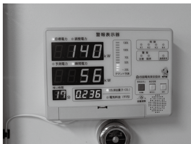
重信中学校に設置されているデマンド監視装置
