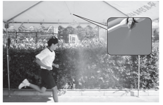
テント内に設置されたミストシャワー
