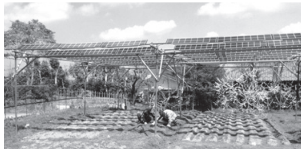
営農を継続しながら、太陽光発電を行う「ソーラーシェアリング方式」の太陽光パネル設置状況
