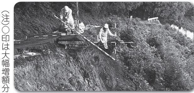
台風被害の現場(市道久尾線)
