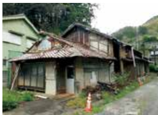
老朽危険空家
