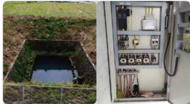
ポンプ設備を更新する「水木泉」
