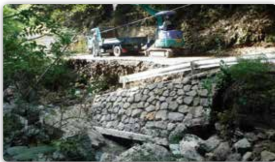
明河 九騎線の被災状況
