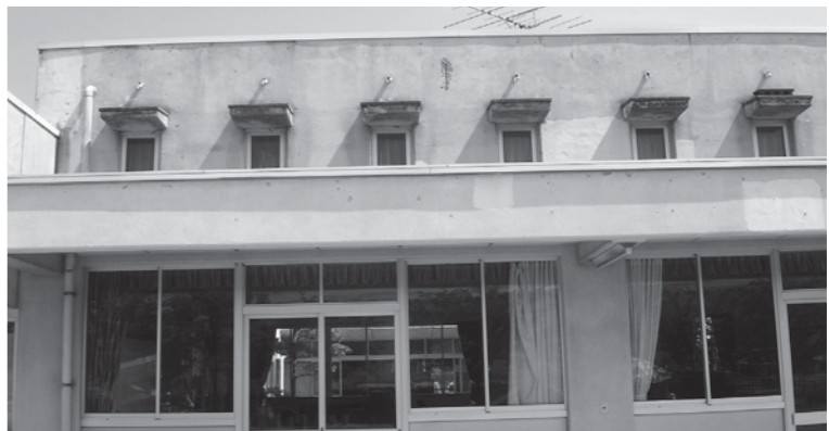
重信幼稚園の老朽箇所
