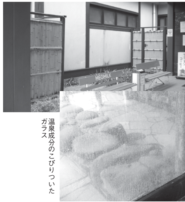
さくらの湯 古くなった竹塼とシミのついた壁
