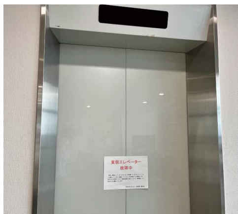
使用中止していた庁舎エレベーター
