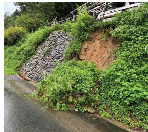
日浦線崩土（重機借上）
