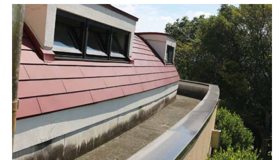
雨漏りしている管理棟の屋根
