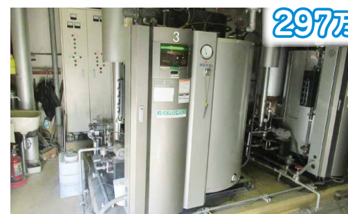
BDFを使用するボイラー
