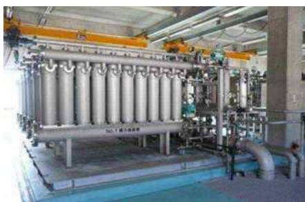
【浄水場(膜ろ過施設)】
