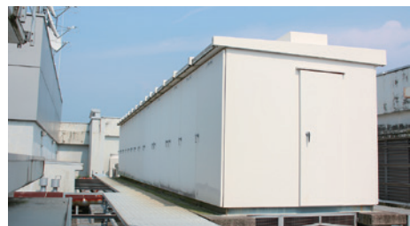
改修予定の高圧受変電設備
