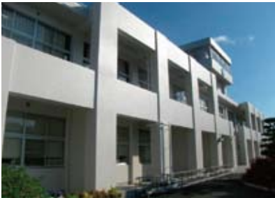
川上小学校南校舎の耐震補強改修工事を実施しました。
