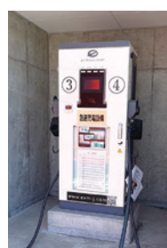
EVバス充電設備
