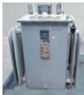
高圧トランスの例
