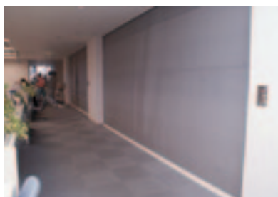
防火シャッター作動後
