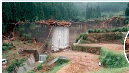
土石流発生後：成谷川えん堤
