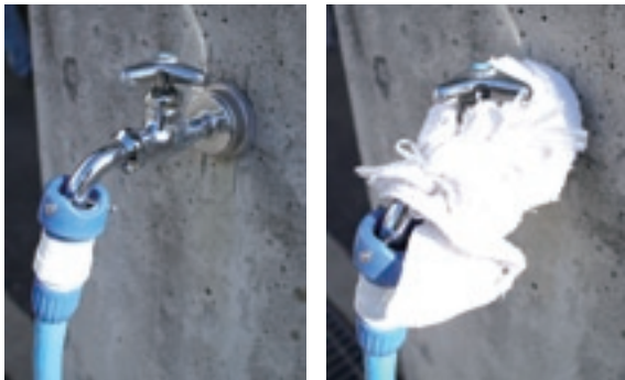
水道管の露出部分に布を巻くだけでも凍結防止効果があります。
