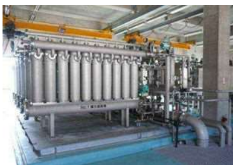
【浄水場(膜ろ過施設)】
