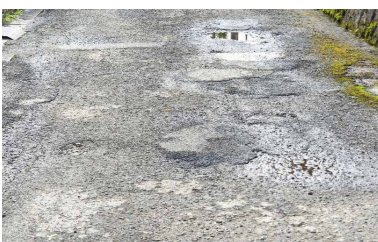
数十世帯が共用する損傷した公道のように利用される私道の現状
