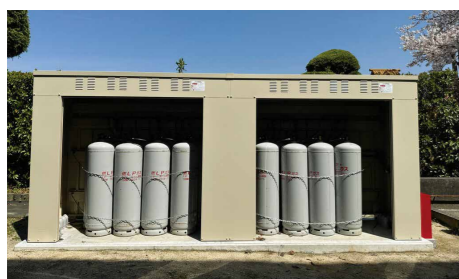
発電機に利用するガス
