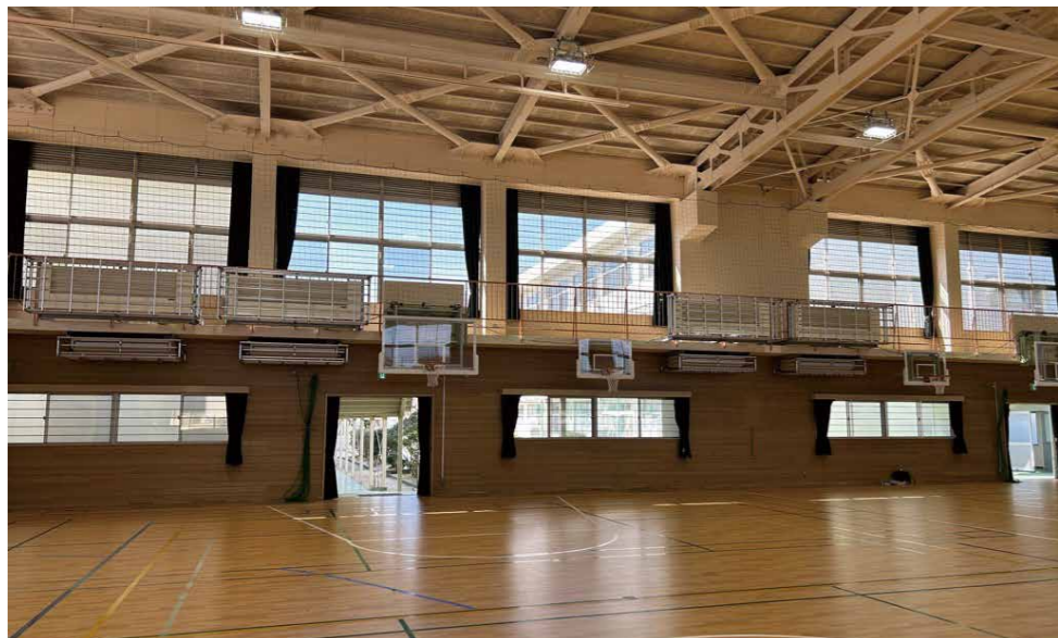
空調設備が整備された南吉井小学校体育館
