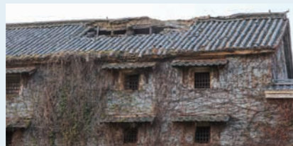
▲大蔵の屋根の損傷状況
