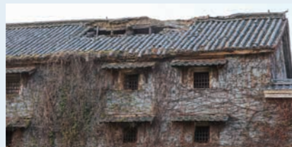
▲大蔵の屋根の損傷状況
