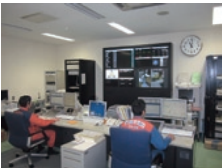
消防救急デジタル無線・指令システム
