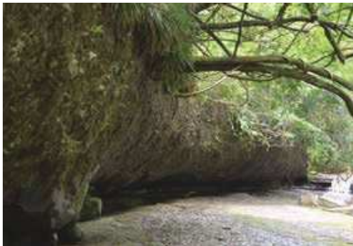
写真3-15 侵食を受けた右岸
