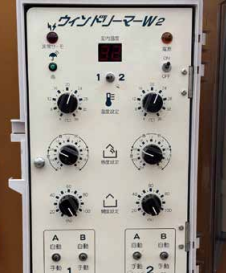
いちごハウスを設定温度に自動換気する装置
