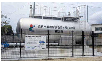
南吉井小学校に設置された 飲料水兼用耐震性水槽
