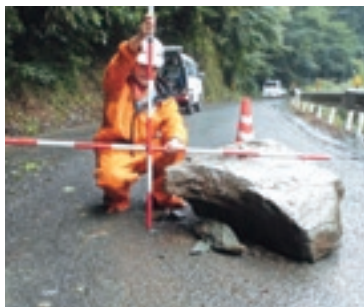
滑川の県道皿ヶ峰公園滑川線で幅1mの落石がありました。
