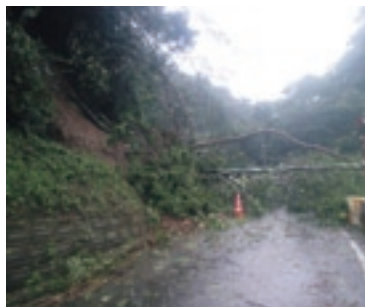
松瀬川の市道添谷相之谷線で土砂崩れがあり、市道が通行止めとなりました。
