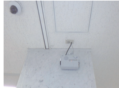
庁舎防災行政無線戸別受信機
