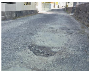
劣化が激しい生活道路
