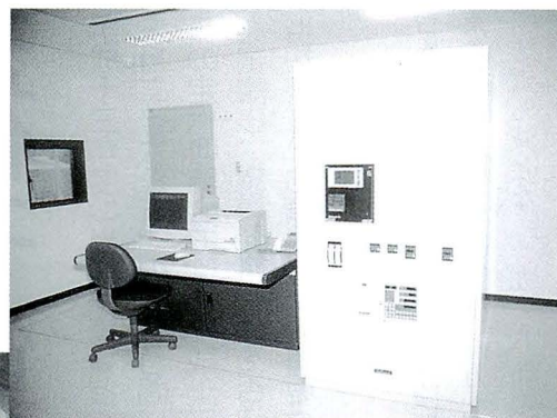
②管理棟 の監視室
