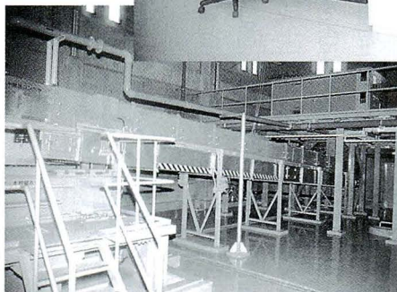
③汚泥処理棟の 汚泥脱水機ほか
