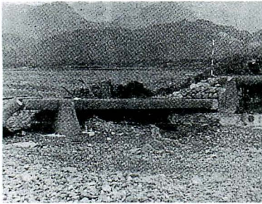
▲台風10号被害・上村えん堤(S45)
