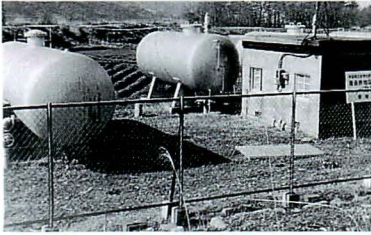
▲町営最初の簡易水道施設(S44)
