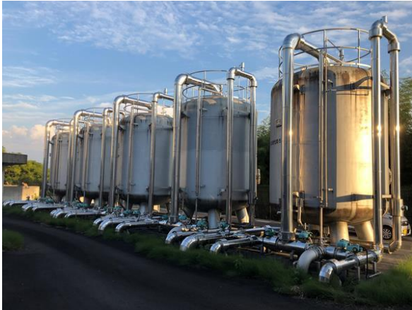
南吉井浄水場 活性炭ろ過機
