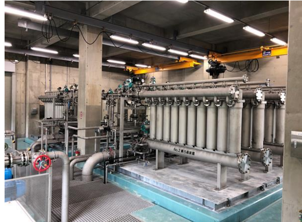
北吉井浄水場 膜ろ過設備
