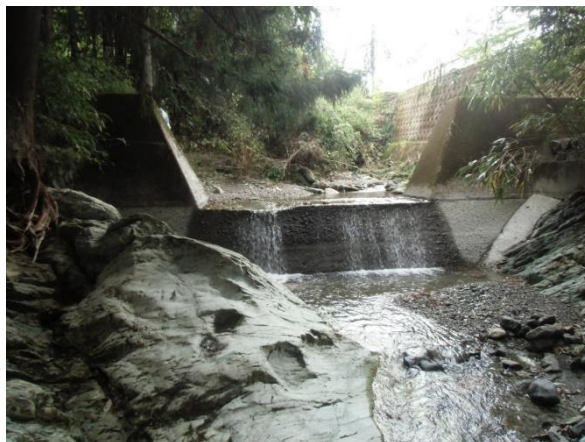
土谷水源（表流水） 図 水道施設の状況
