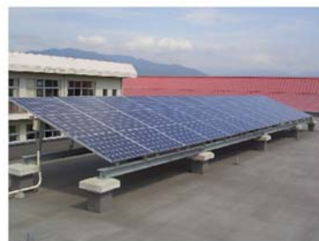
太陽光発電設備（南吉井小学校）
