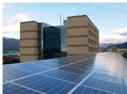
東温市庁舎屋上の太陽光発電パネル
