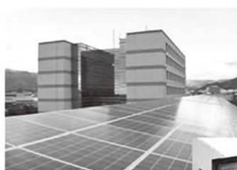
庁舎屋上の太陽光発電パネル
