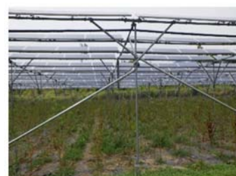
遠赤青汁(株) (49.5kW) 「弘川太陽光発電所」
