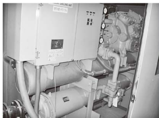
写真13 排熱回収電気式ヒートポンプチラー
