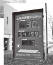
駐車場の表示モニター
