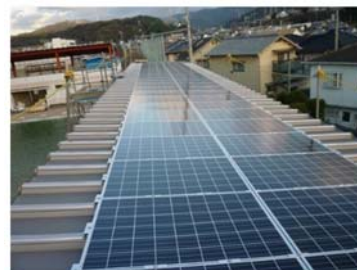
太陽光発電設備（川内中学校）
