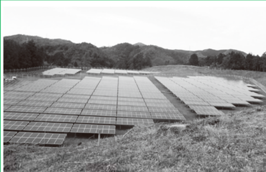
写真3 愛媛日産自動車㈱ (1,603kW) 樋口MS太陽光発電所
