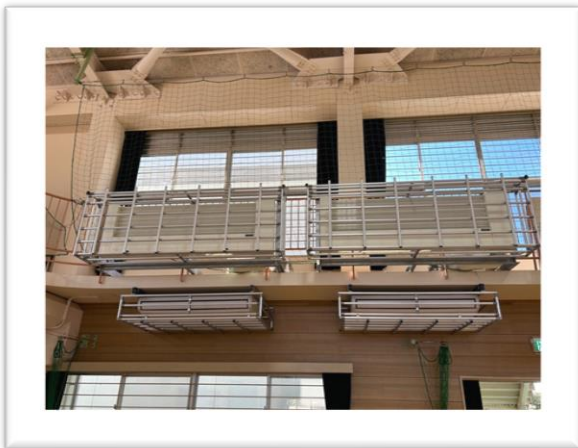
▲指定避難所空調設備
