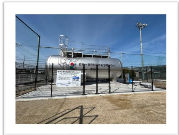
▲飲料水兼用耐震性貯水槽
