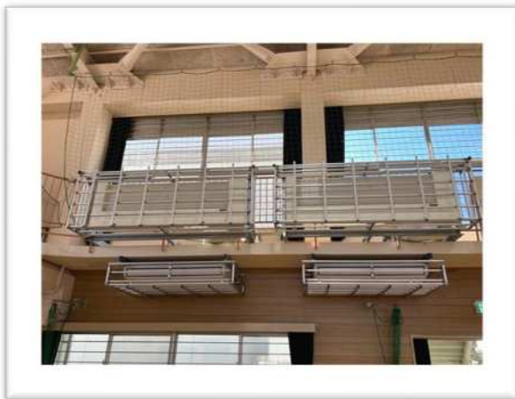
▲指定避難所空調設備
