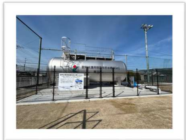
▲飲料水兼用耐震性貯水槽
