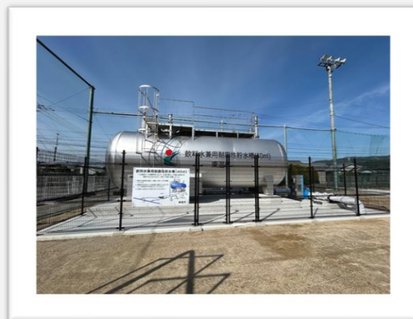
▲飲料水兼用耐震性貯水槽
