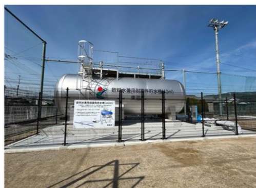
▲飲料水兼用耐震性貯水槽
