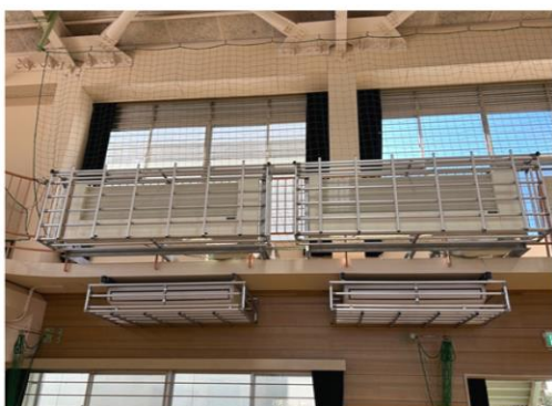
▲指定避難所空調設備
