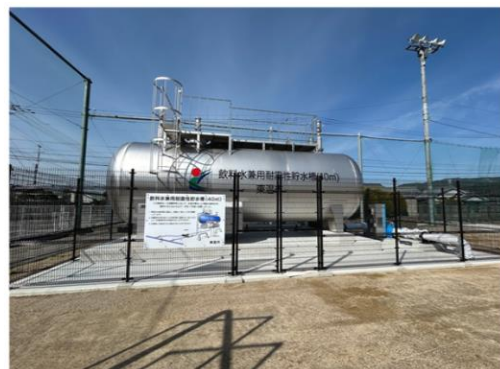
▲飲料水兼用耐震性貯水槽
